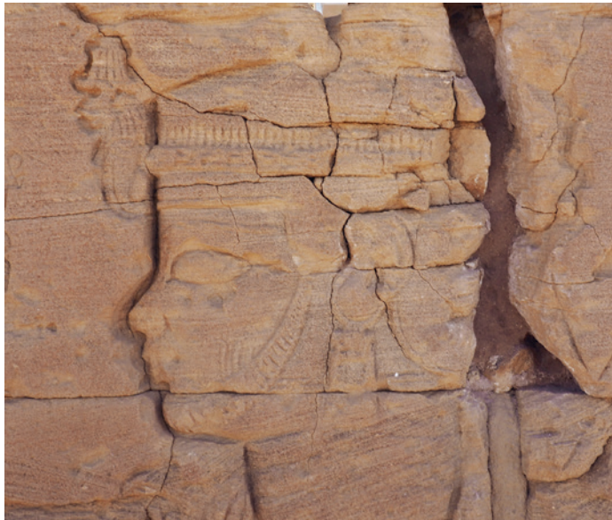
Abb. 23: Löwentempel, Außenwand Westseite, vor der Restaurierung, © Naga-Projekt.
